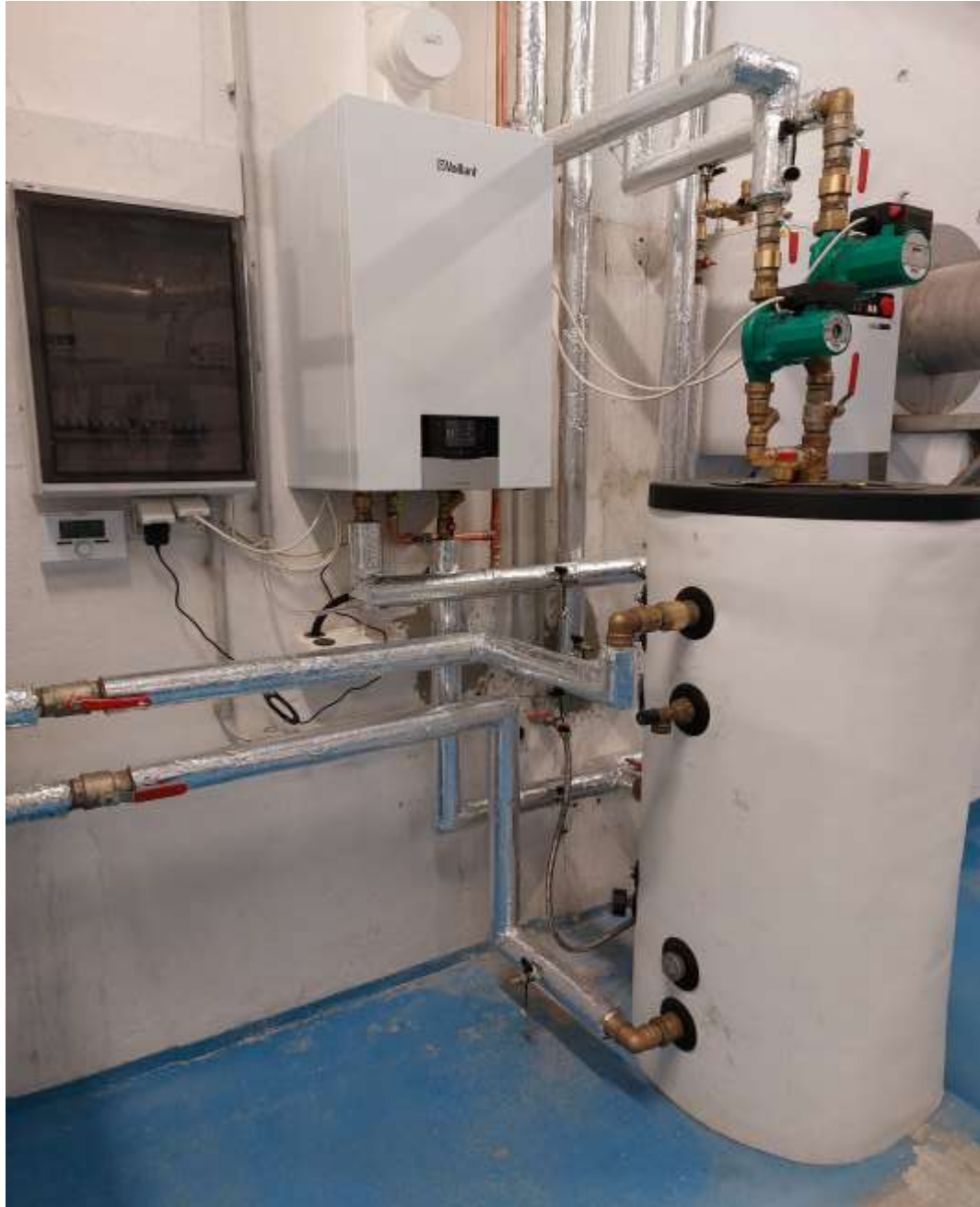
Výměna plynového kotle náklady 167 642 Kč
